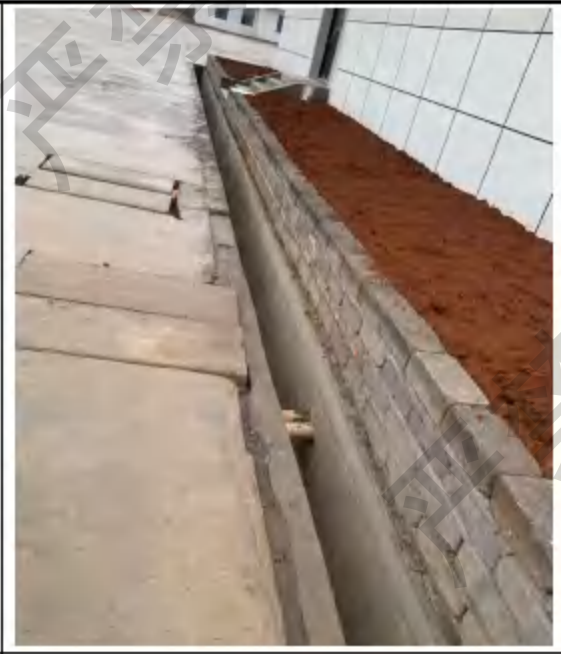
工业广场雨水沟
