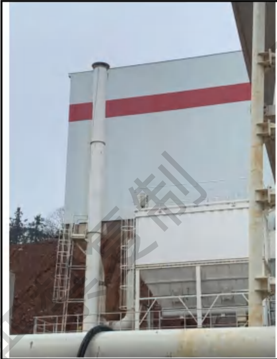
冲击破废气除尘装置
