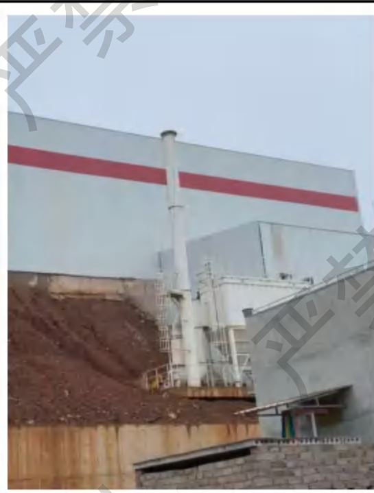
冲击破废气除尘装置
